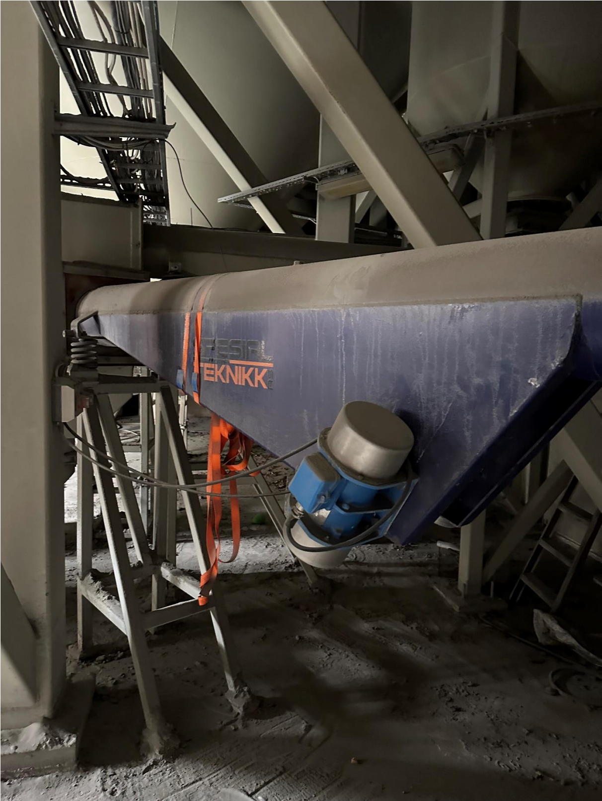
Rør mater fra silo mot mikse-punkt før elevator. Mot produksjon
