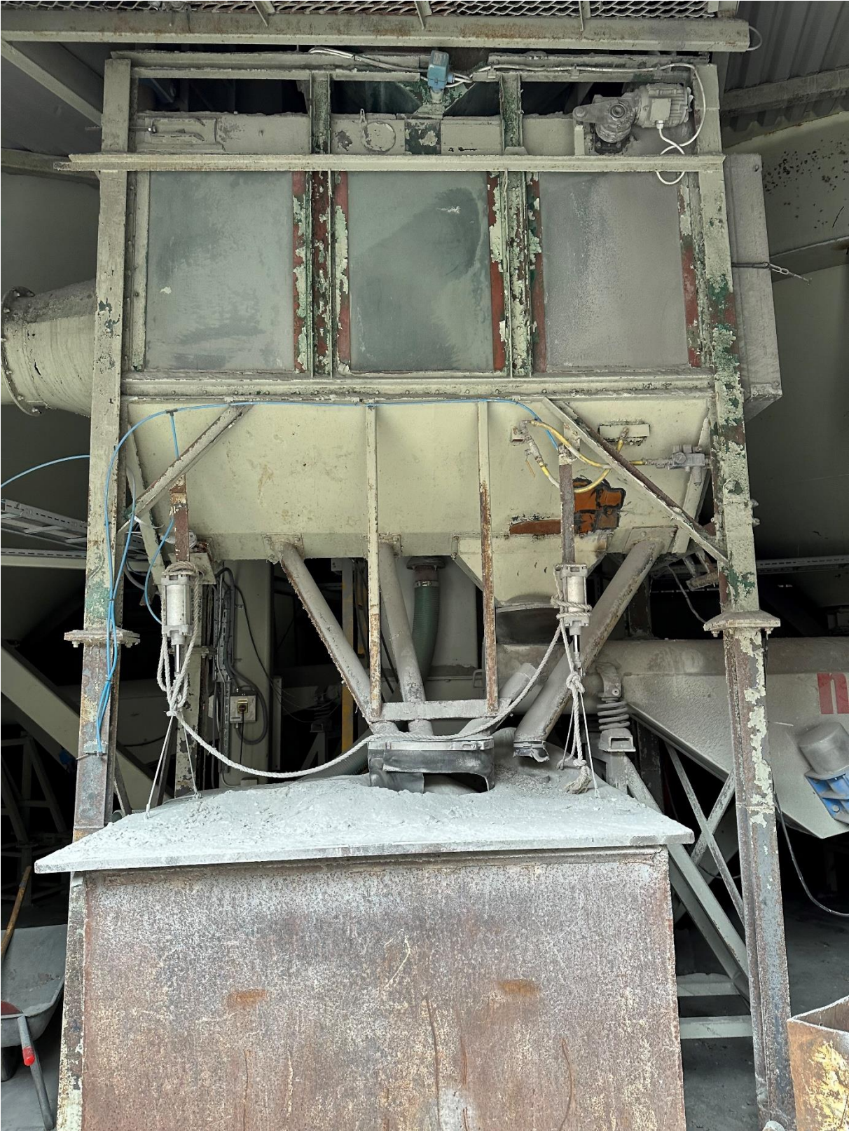
Samle silo under Barmak, med avsug og ventiler
