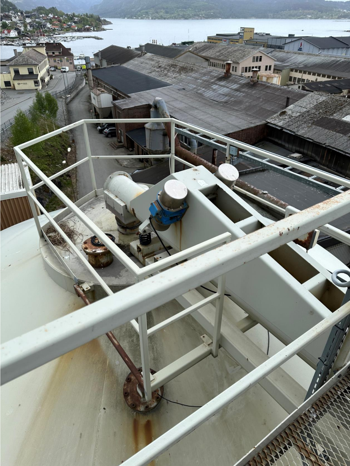
Silotopp med rørmater fra elevator
