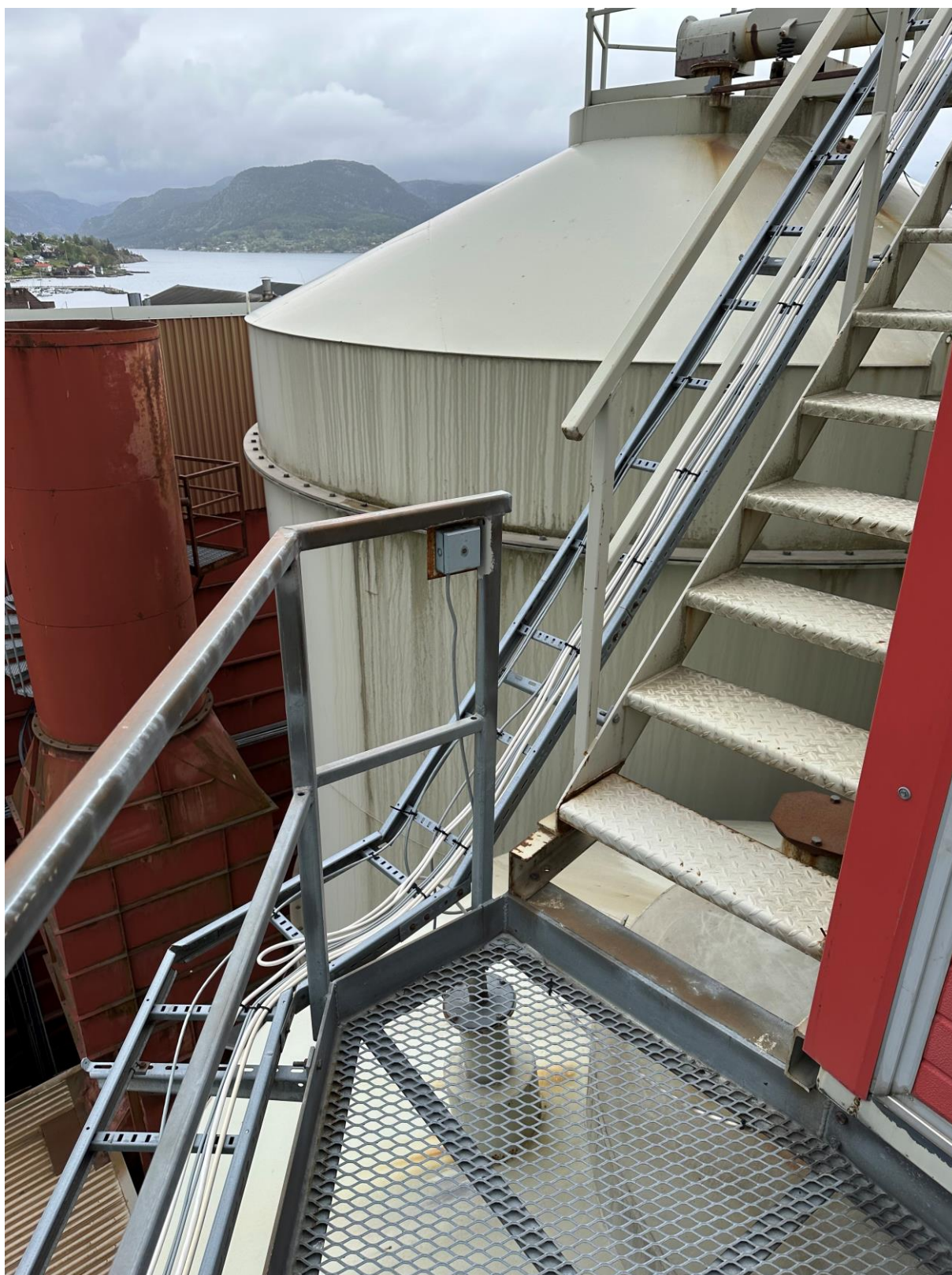
Trapper, gangbaner og føringsveier for kabel
